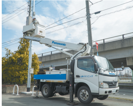
《CS・エンジニアリング事業部》太陽光・風力発電・省エネ設備や様々な施設の音響・映像設備・空調設備を提案。家電製品の修理も
